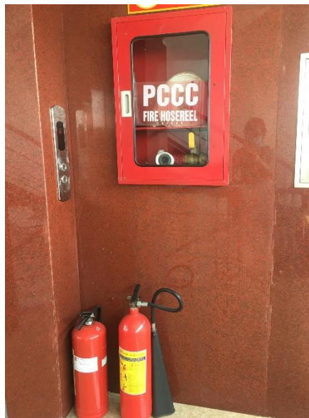
Hình 3. 12. Hình ảnh bố trí dụng cụ chữa cháy tại mỗi tầng của Bệnh viện
