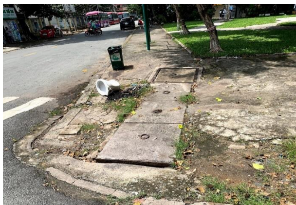
Hệ thống thoát nước trên đường Thanh Đa
