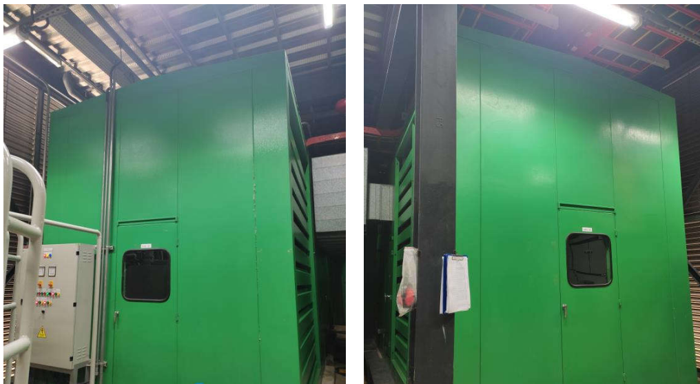
Hình 3. 6. Hình ảnh ống khói và máy phát điện dự phòng
