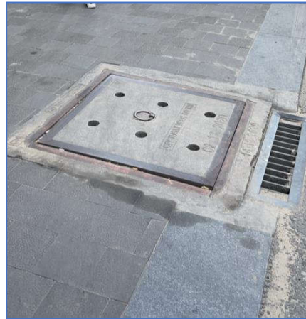
Hố ga thoát nước mưa 2
