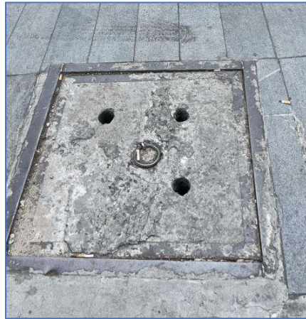
Hố ga thoát nước mưa 1
