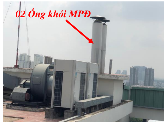
Ống khói máy phát điện
