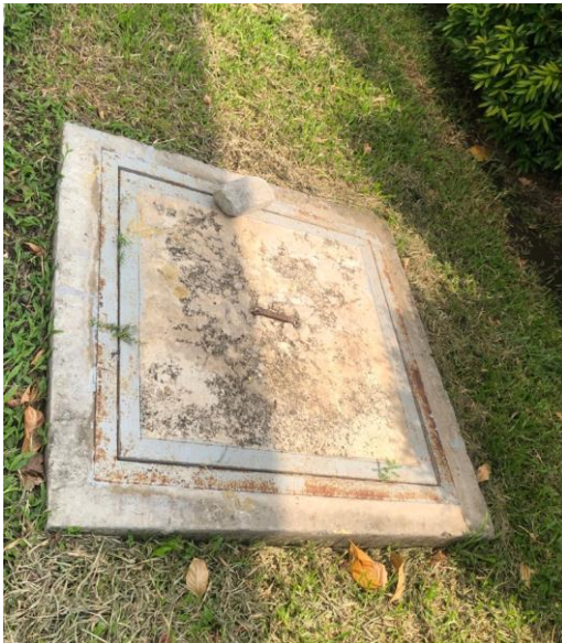
Hố ga thoát nước mưa 1 (đường Nguyễn Lương Bằng)
