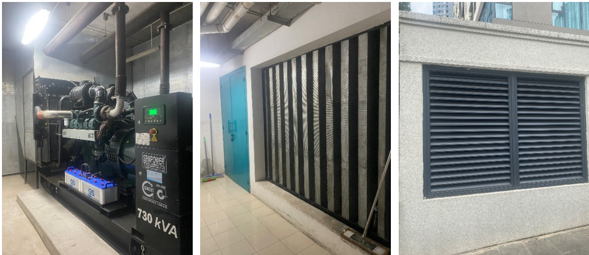
Hình 3.10: Hình ảnh phòng đặt máy phát điện dự phòng của nhà liên kế phố (Shophouse), Khu căn biệt thự liền kề và Khu nhà liên kế vườn (Villas Pearl)
