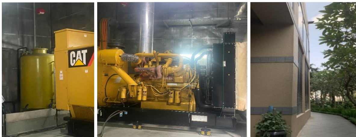
Hình 3.8: Máy phát điện dự phòng Khối chung cư Sapphire
