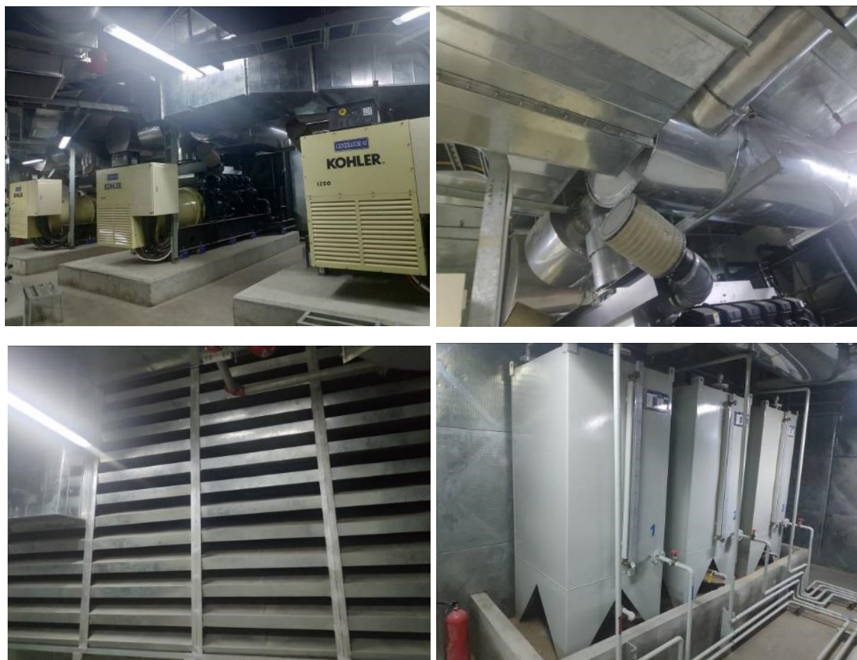
Hình 3.9: Hình ảnh phòng đặt máy phát điện dự phòng của khu Opal
