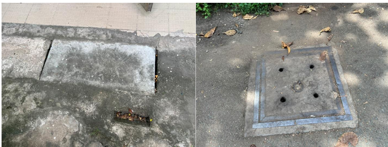
Hình 3. 1. Hình ảnh công trình thoát nước mưa
