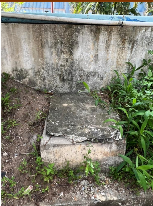
Hình 3. 3. Hồ ga thoát nước cuối trong công ty
