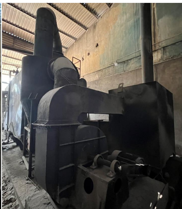
Hệ thống xử lý khí thải
