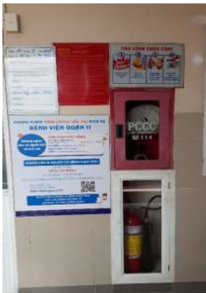
Hình 1. 7. Thiết bị PCCC tại cơ sở
