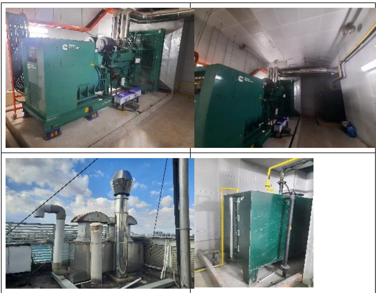
Hình 3. 8 Hình ảnh Máy phát điện - Ống khói Máy phát điện
