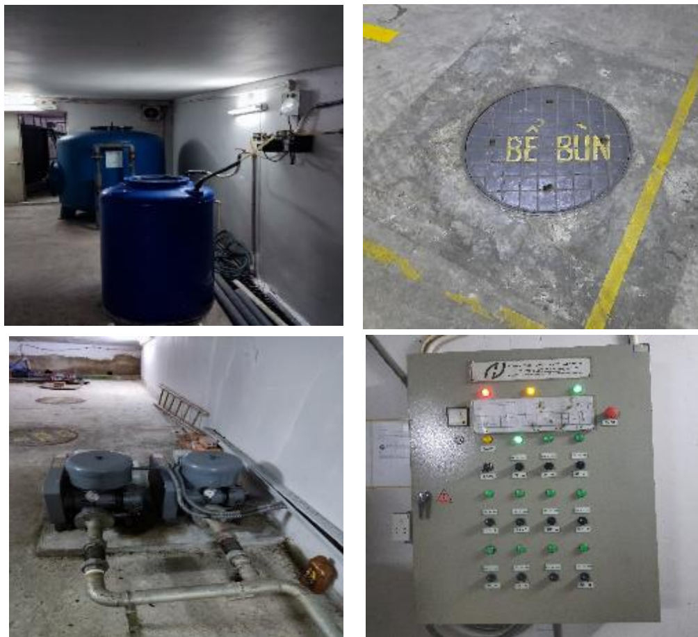
Hình 3. 6 Hình ảnh thực tế Hệ thống xử lý nước thải 200 m 3 /ngày đêm.
