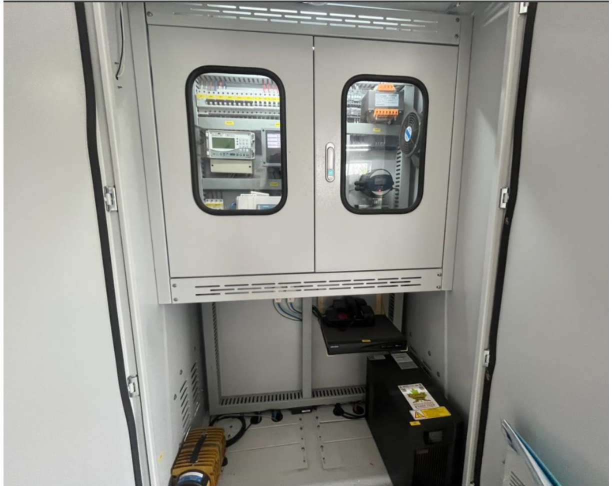
Hình 3. 14. Trạm quan trắc nước thải tự động của Công ty đã được lắp đặt
