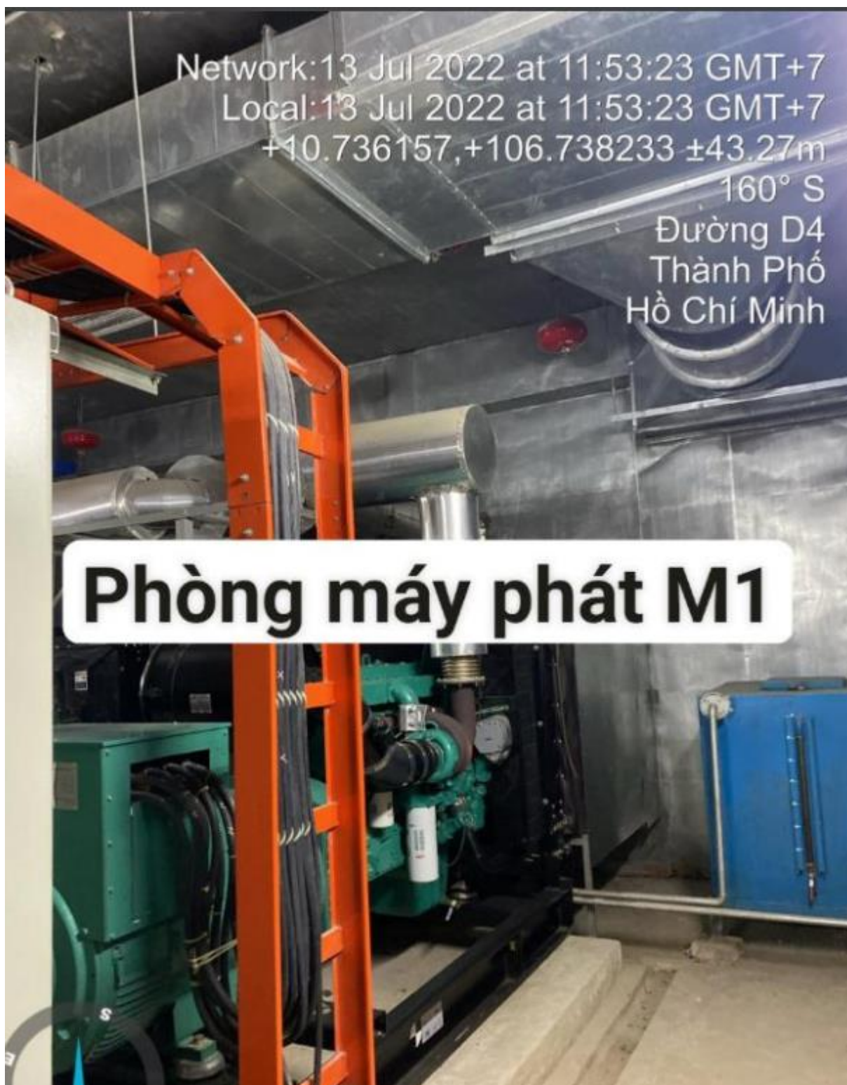
Hình 3. 17. Máy phát điện đặt tại tầng hầm của tháp M1
