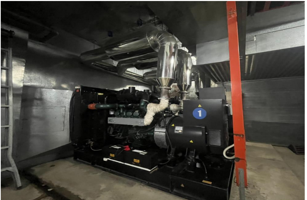
Hình 3. 15. Máy phát điện đặt tại tầng hầm của tháp M2
