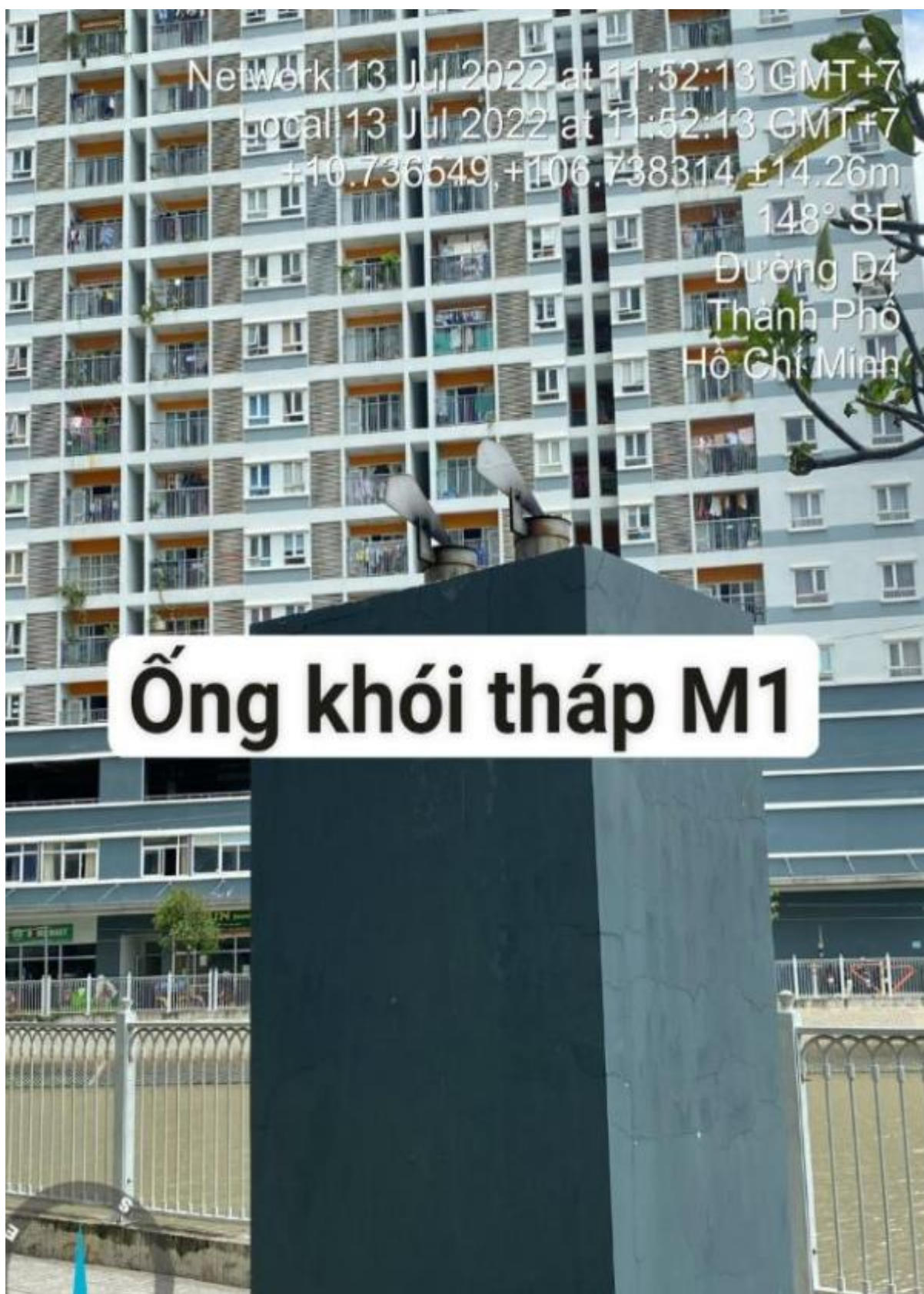
Hình 3. 18. Ống khói của máy phát điện tại tháp M1
