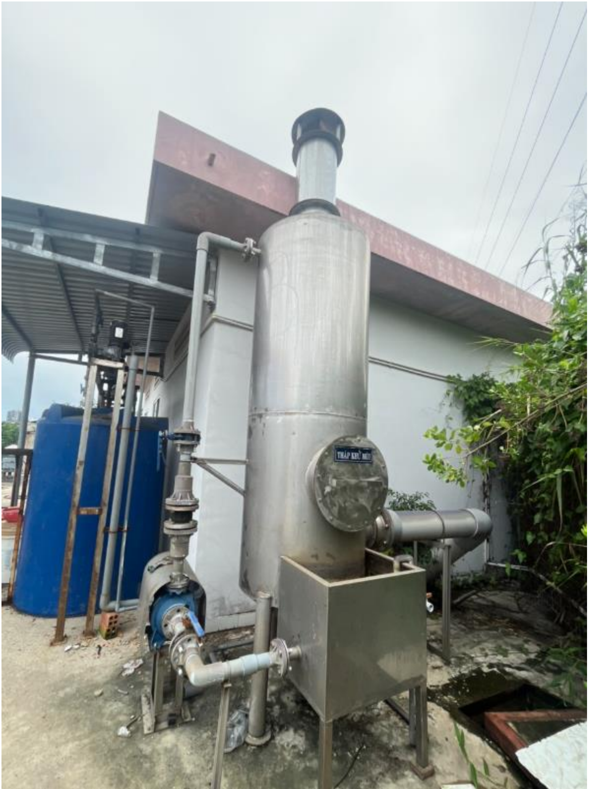
Hình 3. 13. Tháp xử lý mùi tại hệ thống xử lý nước thải của cơ sở
