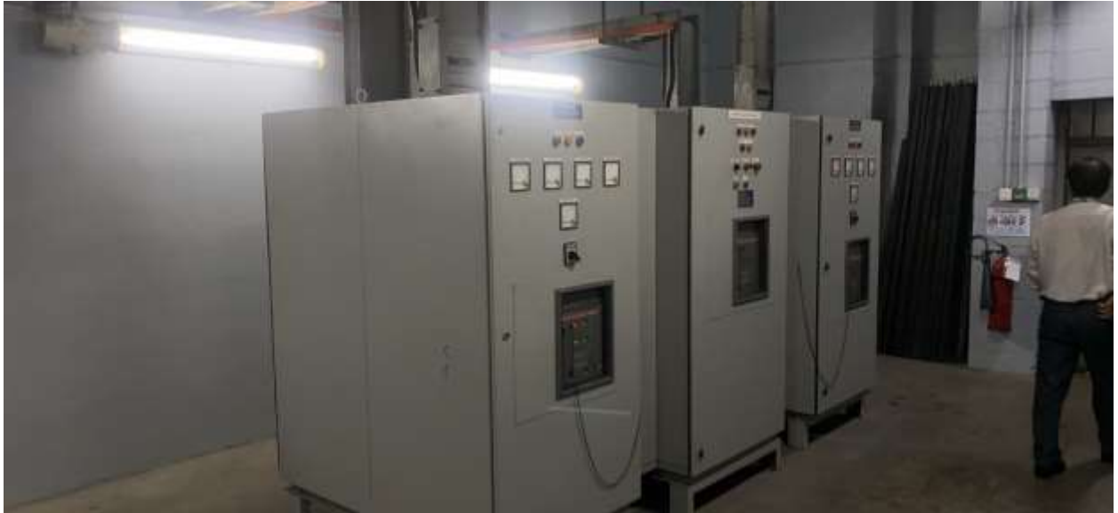
Hình 3. 13. Hệ thống máy phát điện tại Cơ sở
