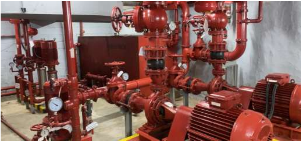
Hình 3. 20. Các thiết bị PCCC tại Cơ sở
