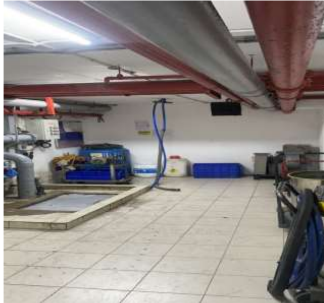
Hình 3. 11. Nơi để hóa chất và tủ điều khiển HTXLNT hầm 1
