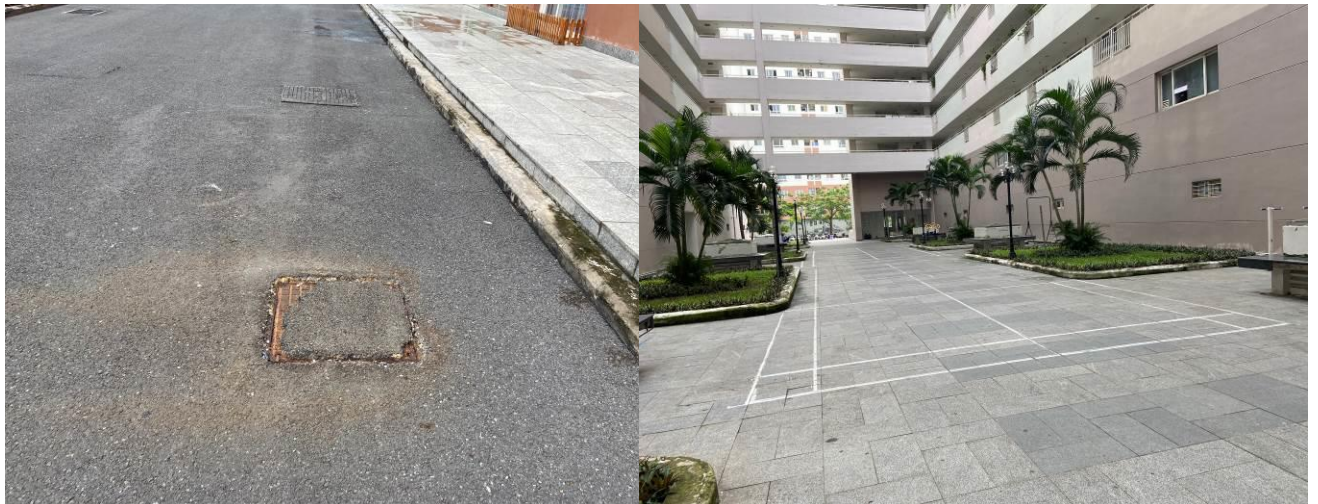
Hình 3.2. Một số hệ thống mương, cống thoát nước mưa của cơ sở
