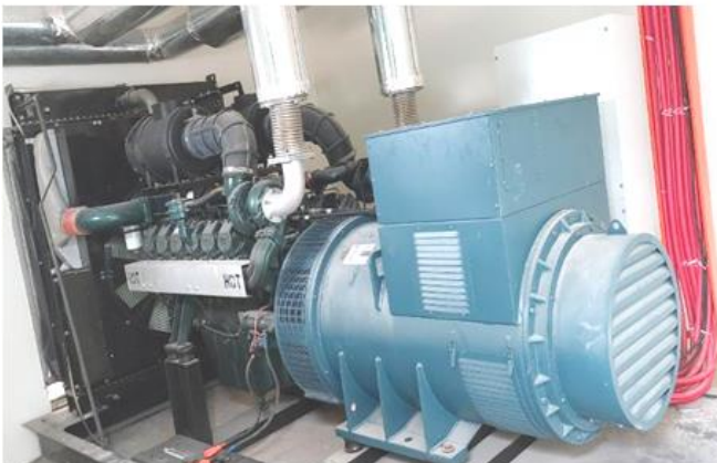
Hình 3.11. Nhà đặt máy phát điện dự phòng
