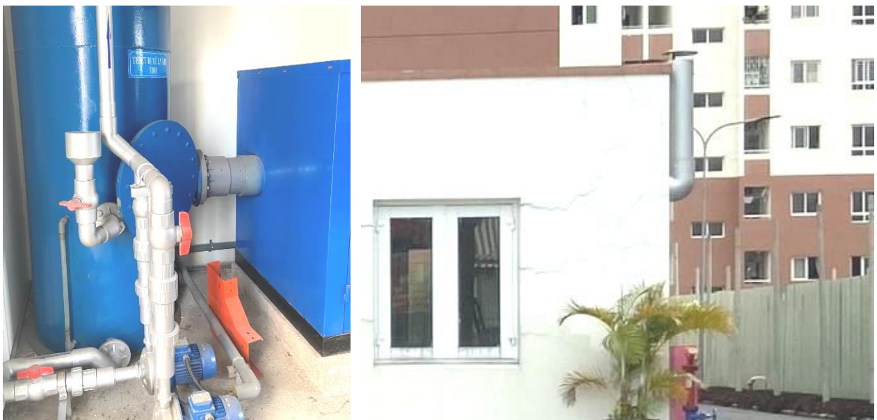
Hình 3.9. Hệ thống xử lý mùi của trạm xử lý nước thải
