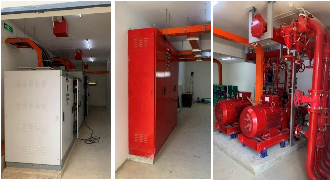
Hình 3.7. Các khu vực đặt máy phát điện dự phòng và bơm chữa cháy
