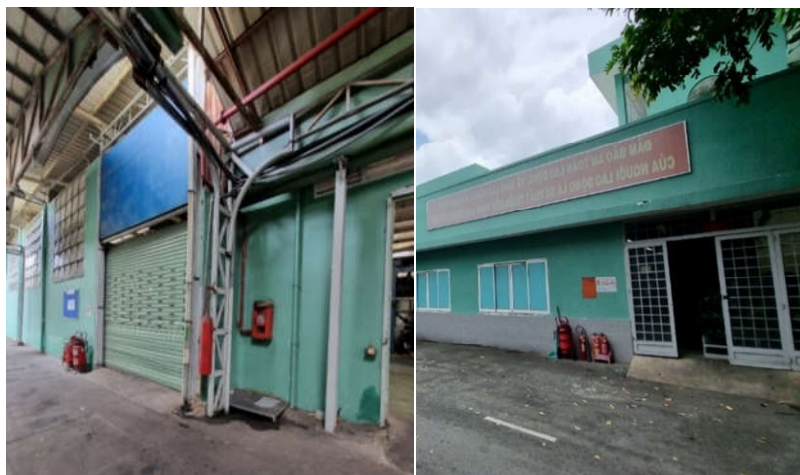
Hình 3.15 Hình ảnh bố trí các bình chữa cháy bên trong và bên ngoài nhà xưởng
