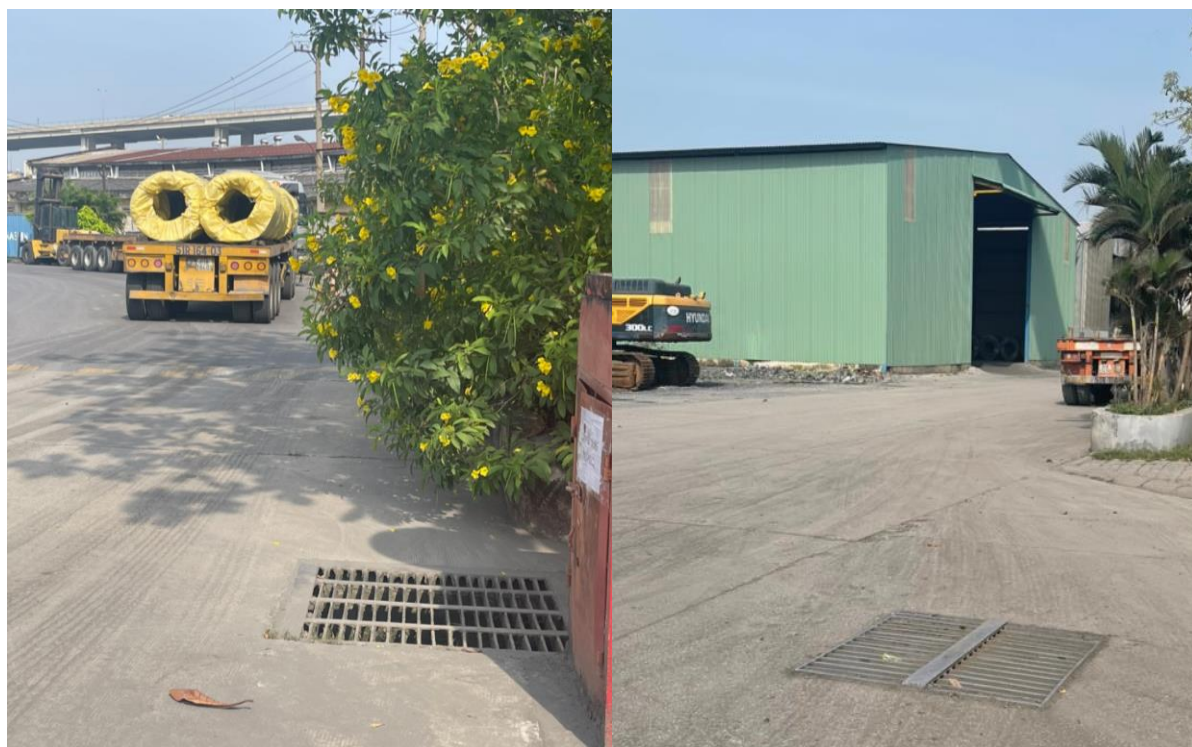
Hình 4. Hố ga thoát nước mưa tại khu vực Cảng Lotus
