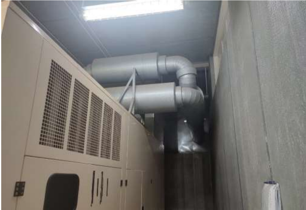
Hình 7 Ống khói máy phát điện
