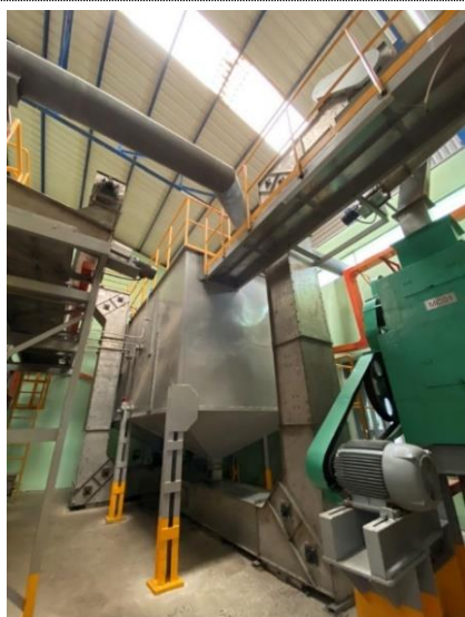
Silo chứa nguyên liệu
