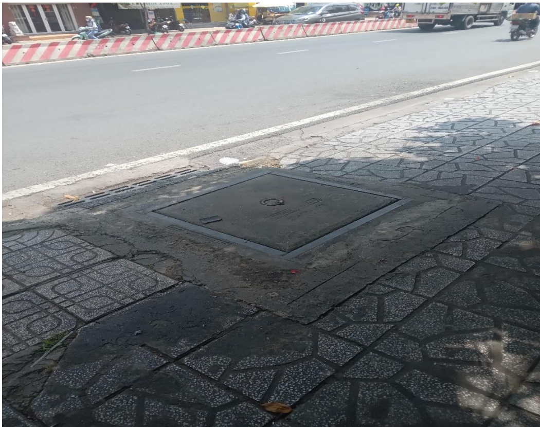
Hình 4.1. Vị trí điểm xả thải của Căn hộ cao cấp Khải Hoàn
