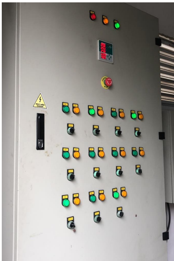
Tủ điều khiển
