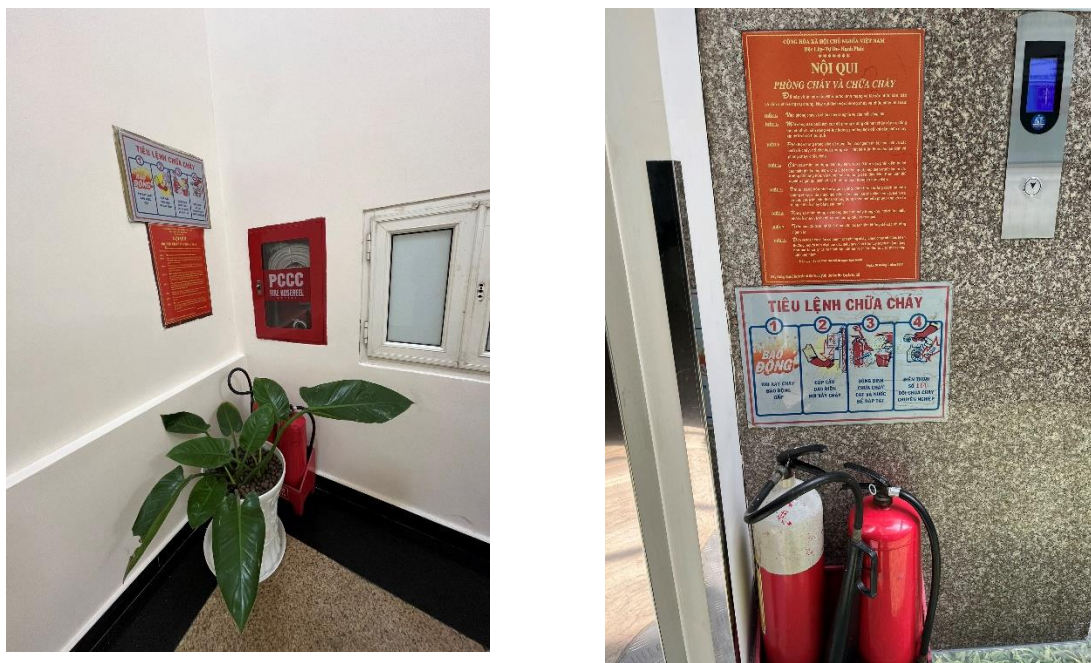
Hình 1. 6. Thiết bị PCCC tại cơ sở
