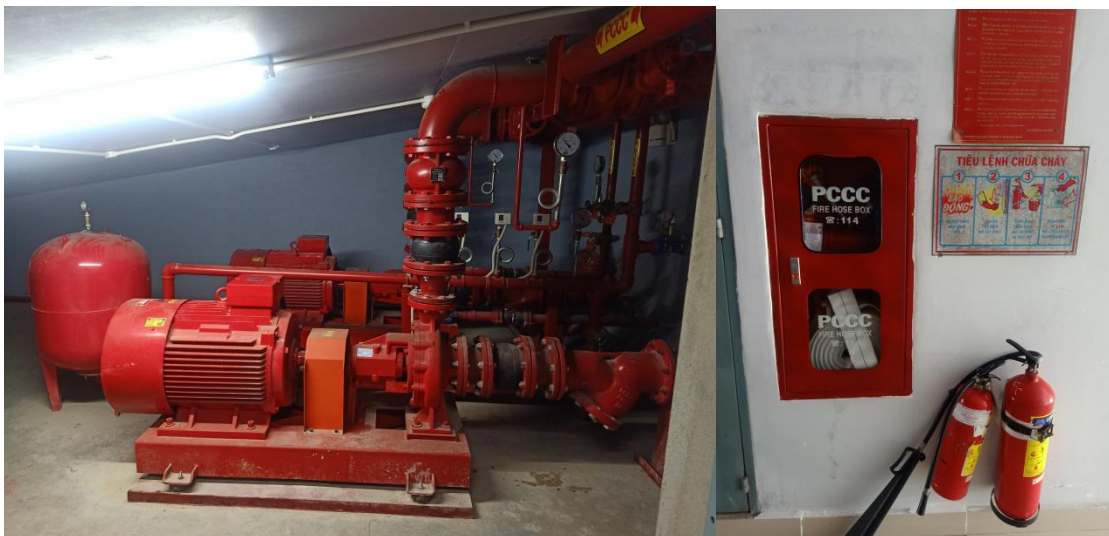
Hình 3.5. Một số thiết bị PCCC tại dự án
