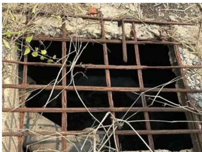
Hình 3. 2 Hồ ga đầu nối nước mưa tại cơ sở
