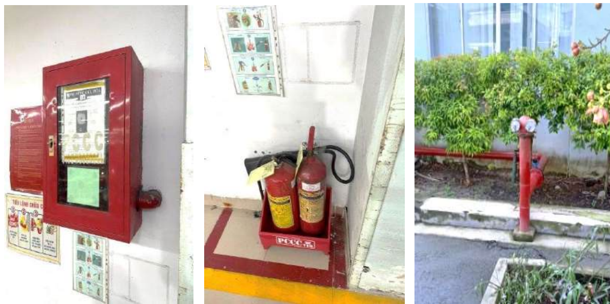
Hình 1. 24 Hệ thống PCCC tại cơ sở
