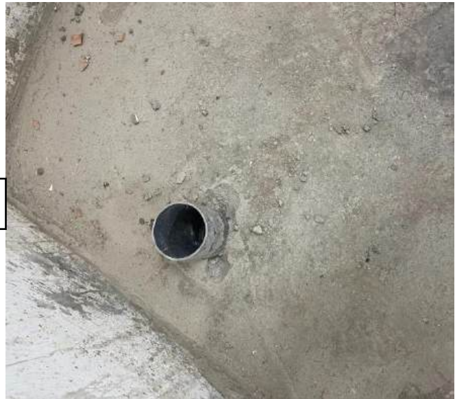
b. Phễu thu nước vệ sinh sàn, thiết bị chứa nhà chứa rác tập trung tại tầng hầm 1
