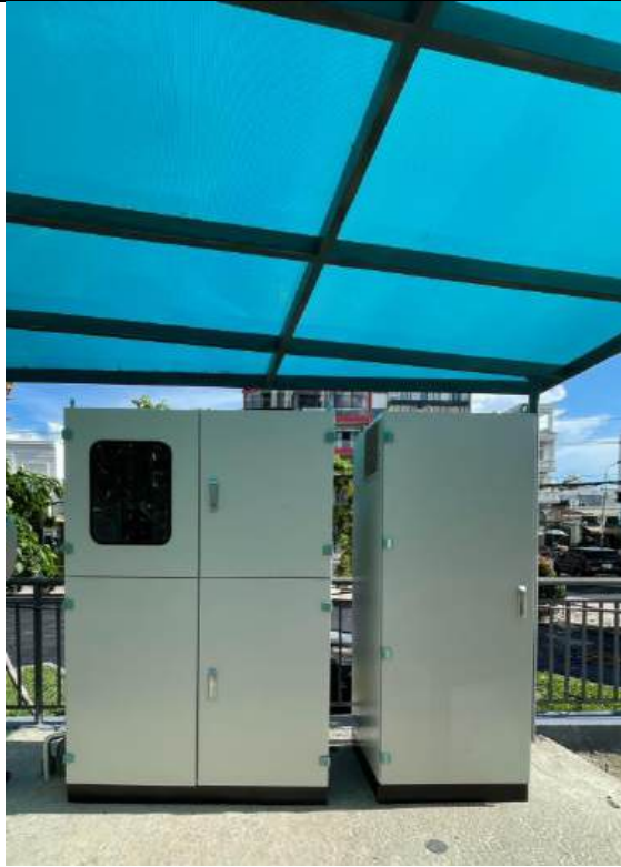
Hình 3. 12: Mô hình hệ thống quan trắc nước thải tự động liên tục, đã lắp đặt tại dự án
