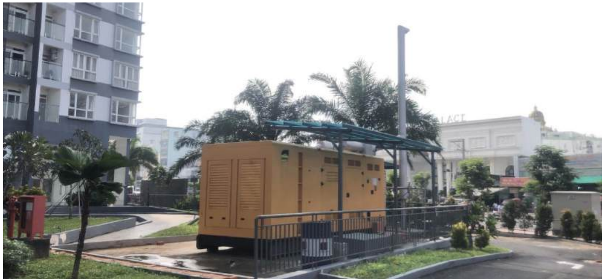
Hình 3. 14: Máy phát điện công suất 1.000kVA
