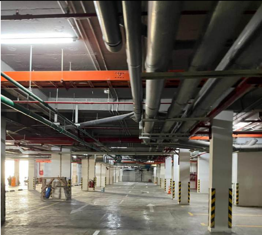
Hình 3. 18: Hệ thống thông gió tầng hầm
