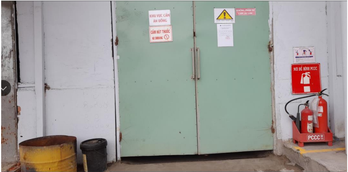
Hình 3.22: Hệ thống PCCC kho chứa chất thải rắn
