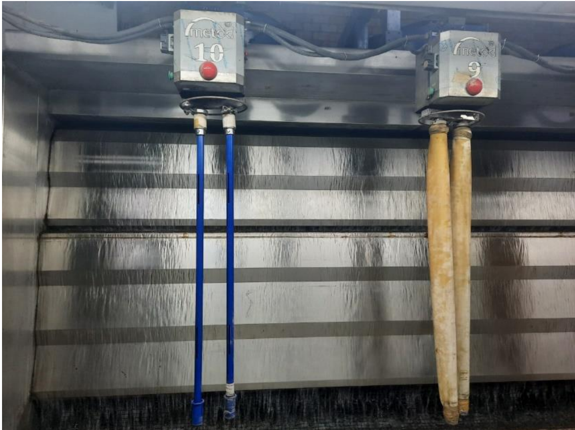
Hình 3.13: Hệ thống màng nước thu gom bụi và khí thải công đoạn xít PP
