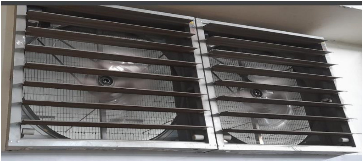
Hệ thống quạt hút
