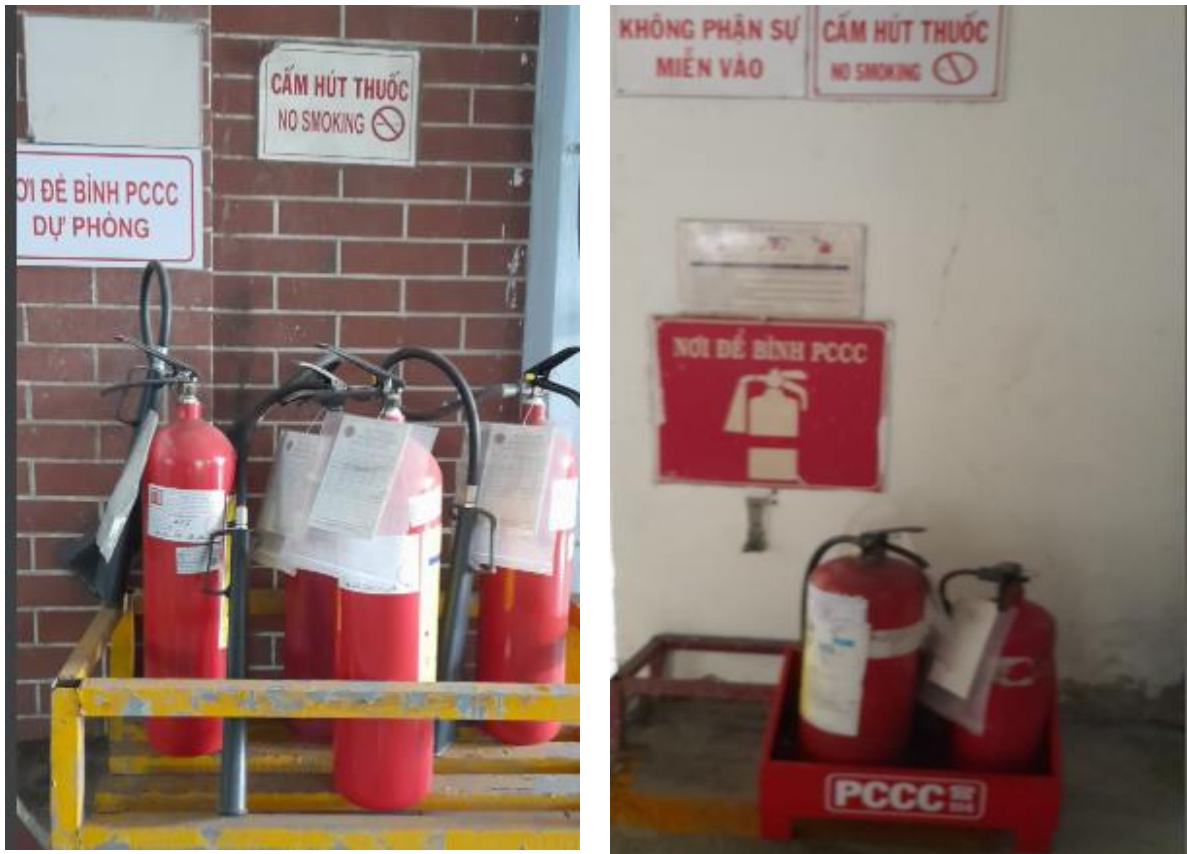
Hình 3.23: Hình ảnh thiết bị PCCC bố trí tại nhà xưởng
