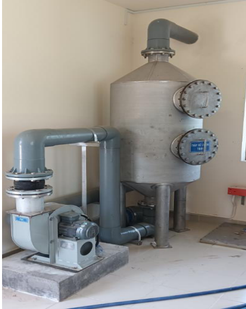
Hình III-4. Bộ phận xử lý mùi
