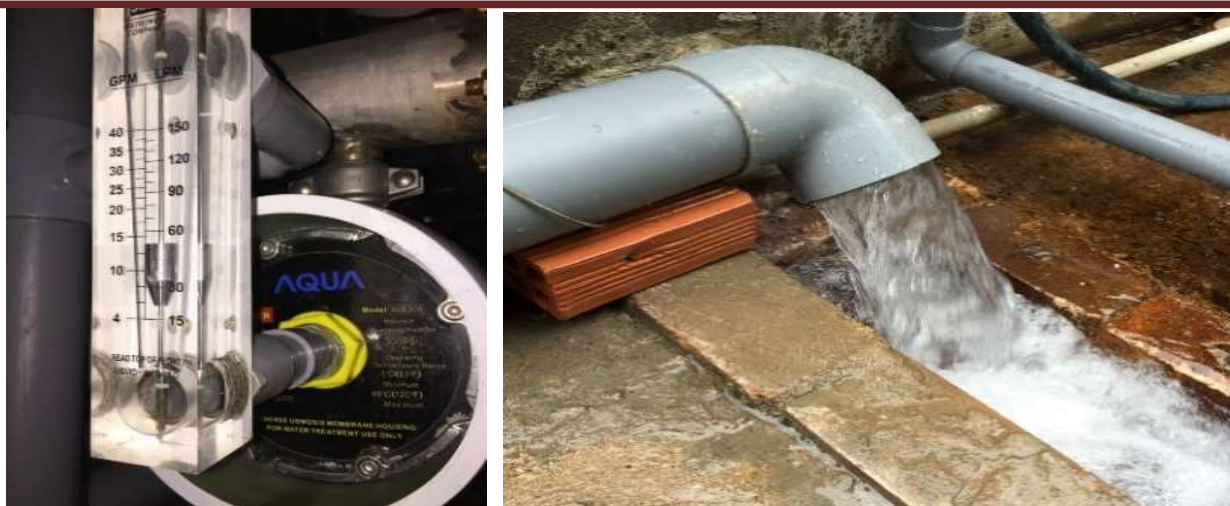
Hình 12. Hình ảnh thực tế trạm xử lý nước thải công suất 450 m 3 /ngày đêm
