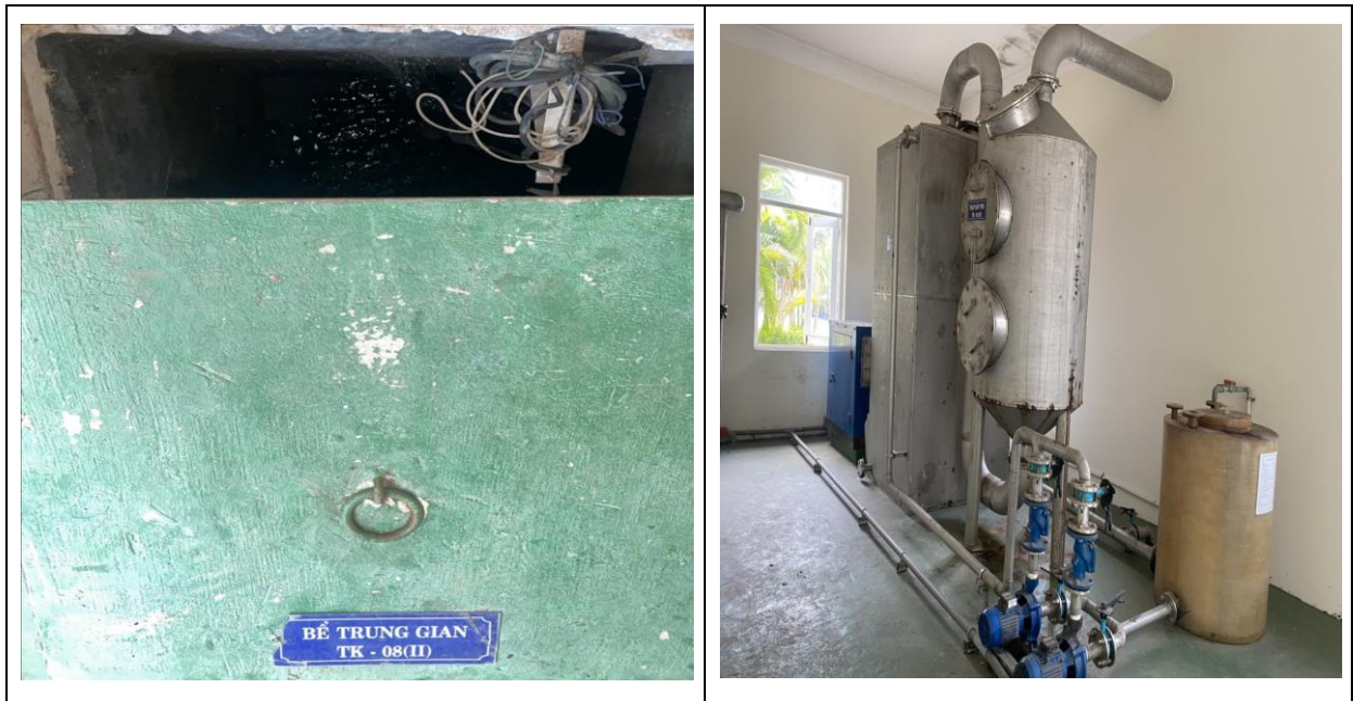
Hình 3.6. Hình ảnh bố trí hệ thống xử lý nước thải, công suất 700 m 3 /ngày.đêm
