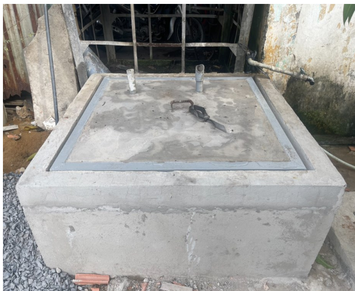
Hình 3.3 Hồ ga lắng cát, rãnh thu gom nước gom nước thải sinh hoạt và sản xuất
