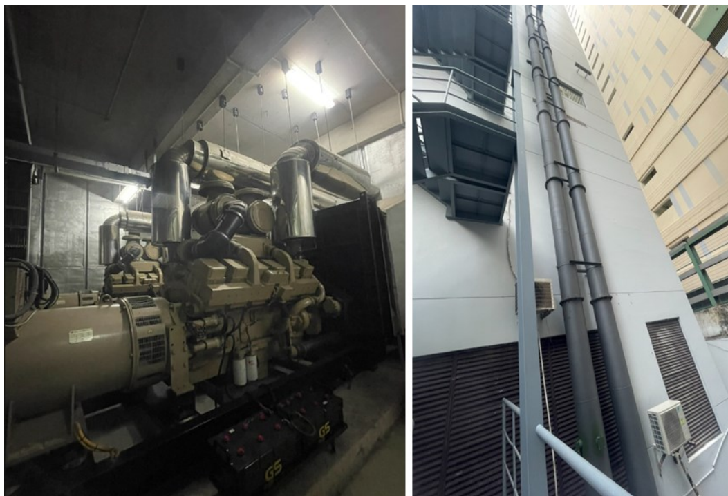
Hình 3.5. Máy phát điện công suất 910 kVA.
