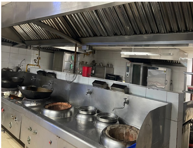
Hình 3.7. Thiết bị hút mùi nhà bếp.
