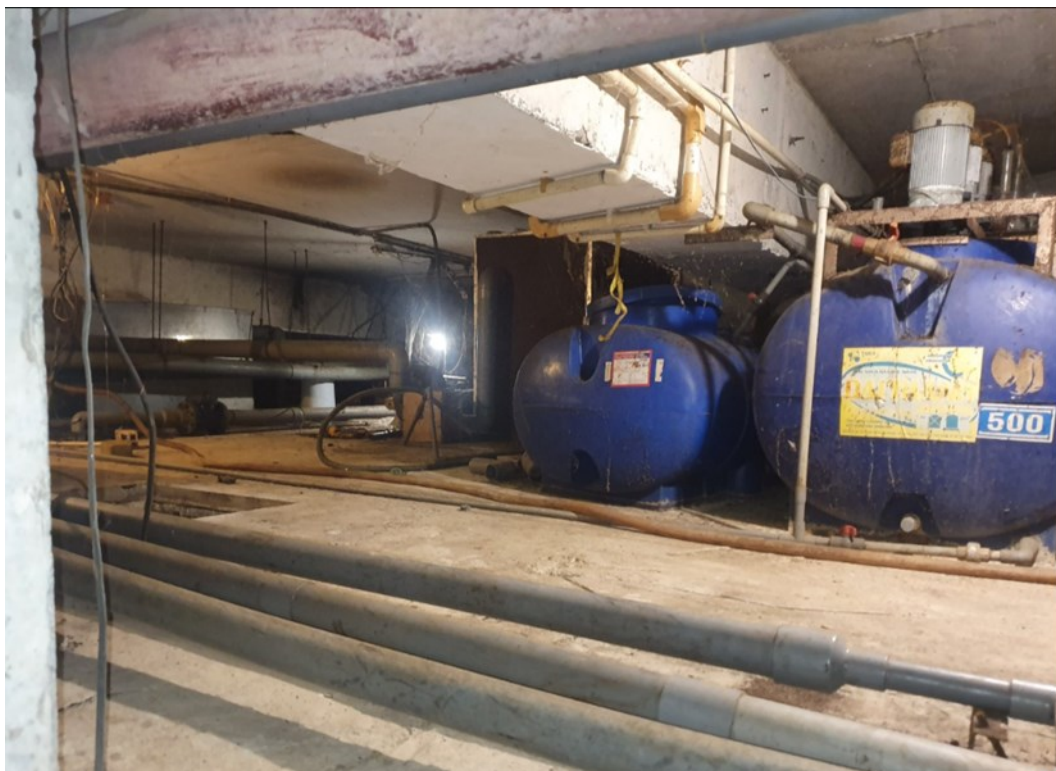
Hình 3.3. Hệ thống xử lý nước thải công suất 220 m 3 /ngày.
