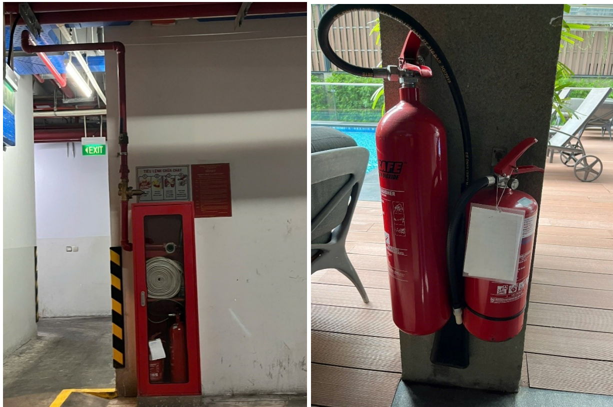
Hình 23. Phương tiện phòng cháy, chữa cháy tại tòa nhà
