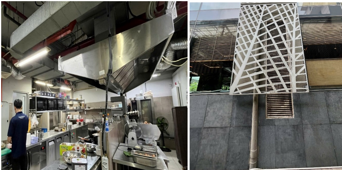
Hình 16. Hệ thống hút mùi tại bếp nhà hàng và hòng xả
