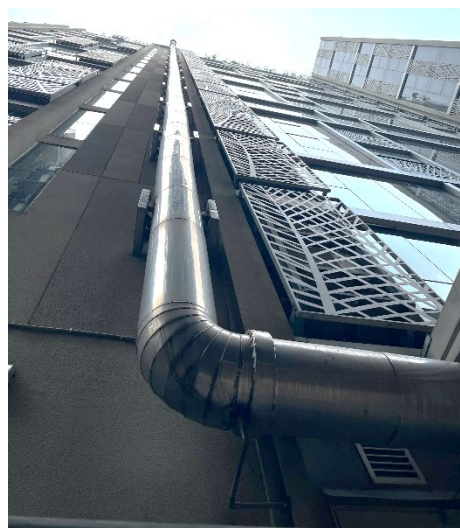
b. Vị trí ống khói máy phát điện
