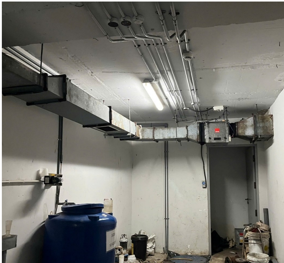
Hình 19. Hệ thống hút mùi tại phòng XLNT của cơ sở
