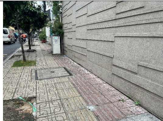
Hố ga thoát nước vào hệ thống thoát nước chung khu vực
