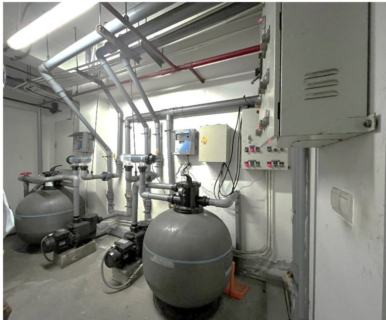
Hình 14. Hệ thống xử lý nước hồ bơi
