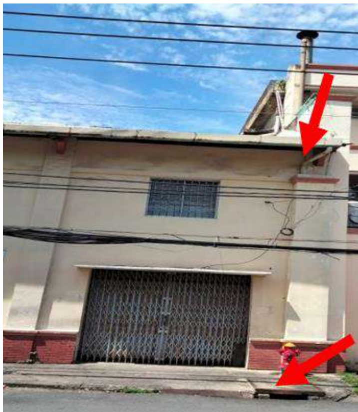
Hình 3. 2. Vị trí hồ ga thu nước mưa của nhà xưởng và ống đứng thu nước mưa
