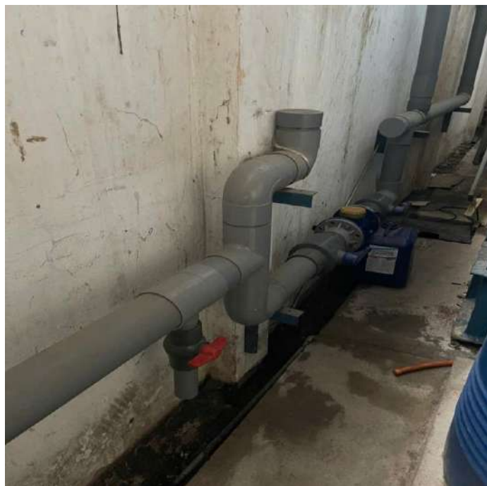
Hệ thống đường ống ra hồ ga đầu nổi
