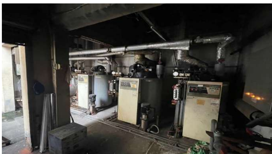
Hình 3. 8. Lò hơi hiện hữu của cơ sở
