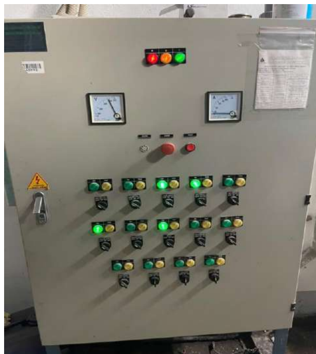
Tủ điện điều khiển HTXLNT
