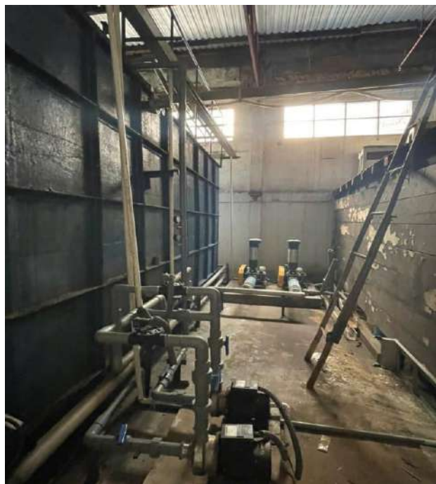
Hệ thống đường ống đầu vào HTXLNT
