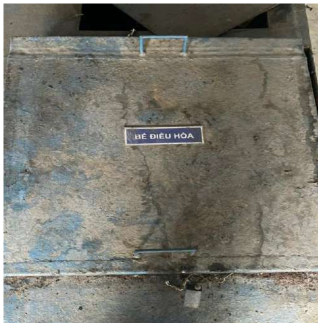
Bể điều hoà
