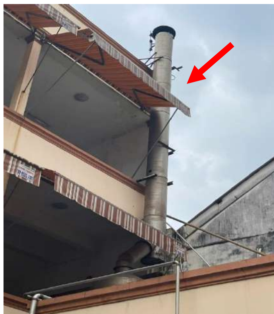
Hình 3. 10. Ống khói thoát ra của hệ thống xử lý khí thải lò hơi
