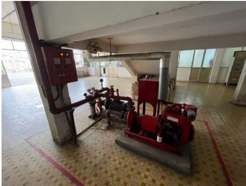
Hình 3. 14. Hệ thống PCCC tại Cơ sở
