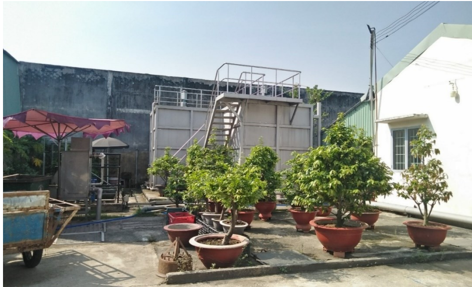
Hình 13. Hệ thống xử lý nước thải tập trung tập trung
