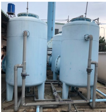
Hình 6. Cụm bồn xử lý nước ngầm
