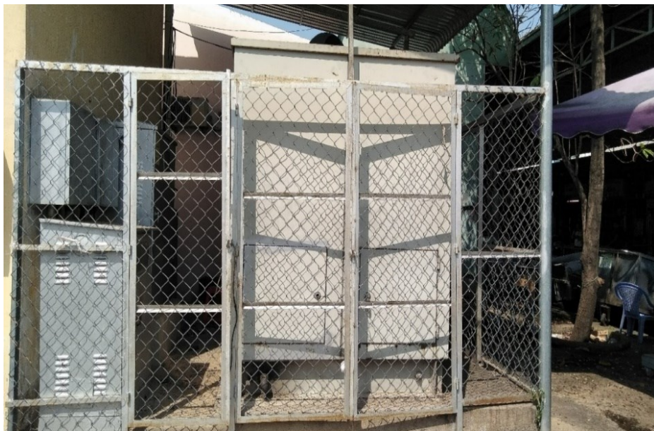
Hình 15. Máy phát điện đặt gần khu nhà lồng chợ thịt
