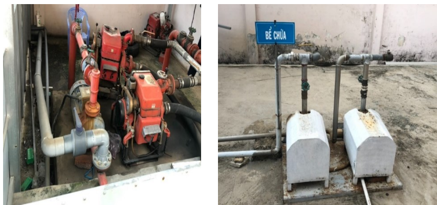
Hình 18. Bể chứa nước và bơm PCCC tại cơ sở
