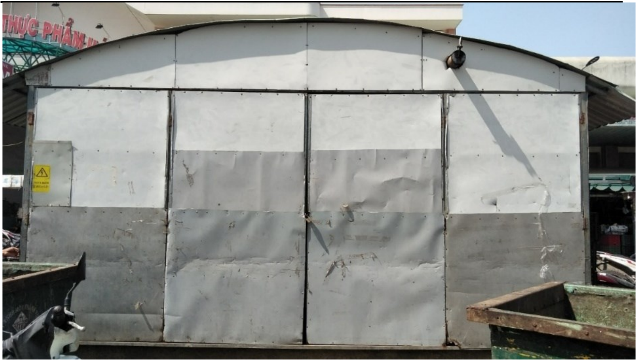
Hình 14. Máy phát điện đặt gần khu nhà lồng chợ rau
