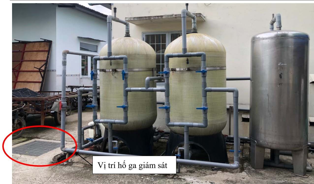
Hình 11. Vị trí hố ga giám sát của hệ thống xử lý nước thải
