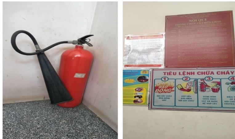
Hình 17. Bình CO 2 và các biển báo PCCC được trang bị tại nhưng nơi dễ nhìn thấy
