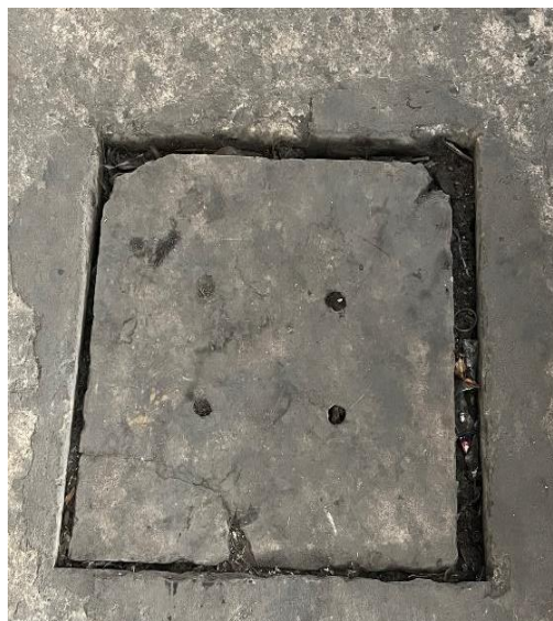
Hố ga thu gom nước thải
