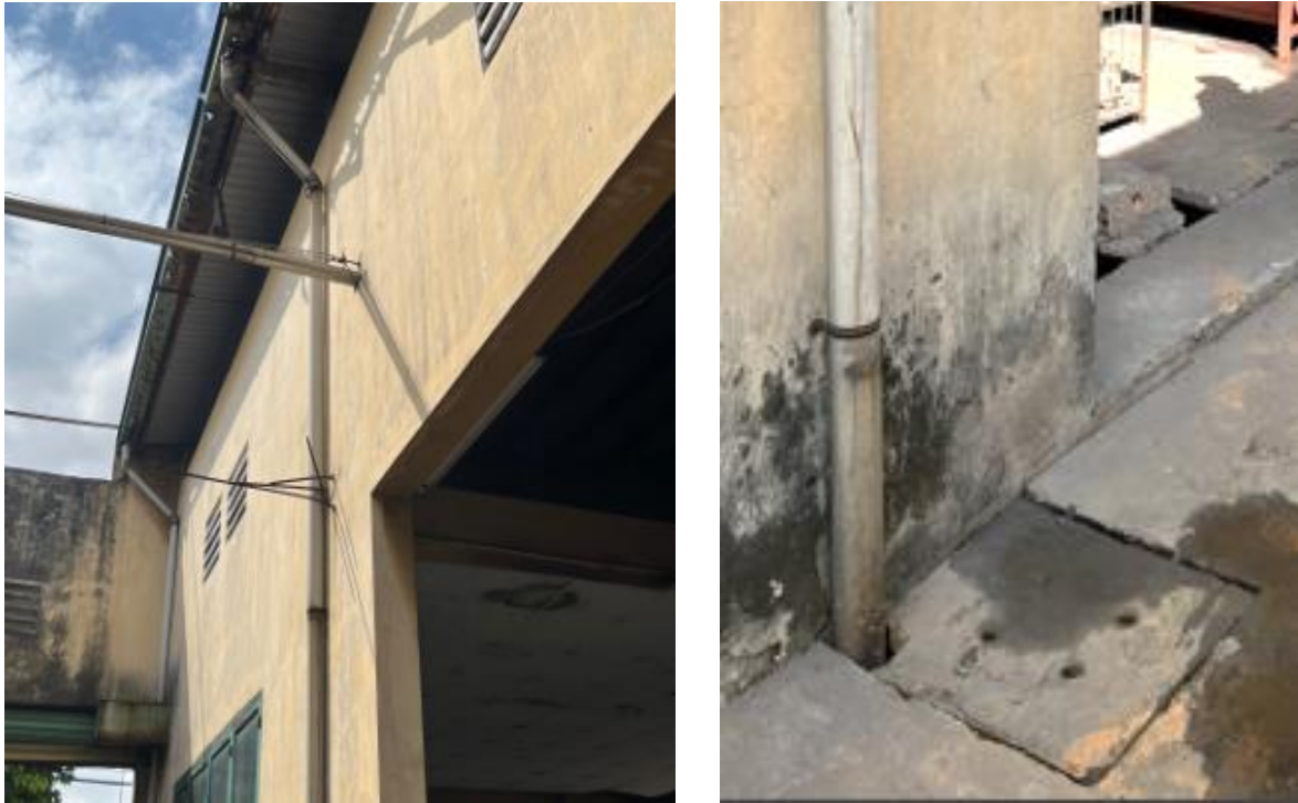
Hình 3.2. Đường ống thoát nước mưa trên mái và hố ga thoát nước mưa trong nội bộ
