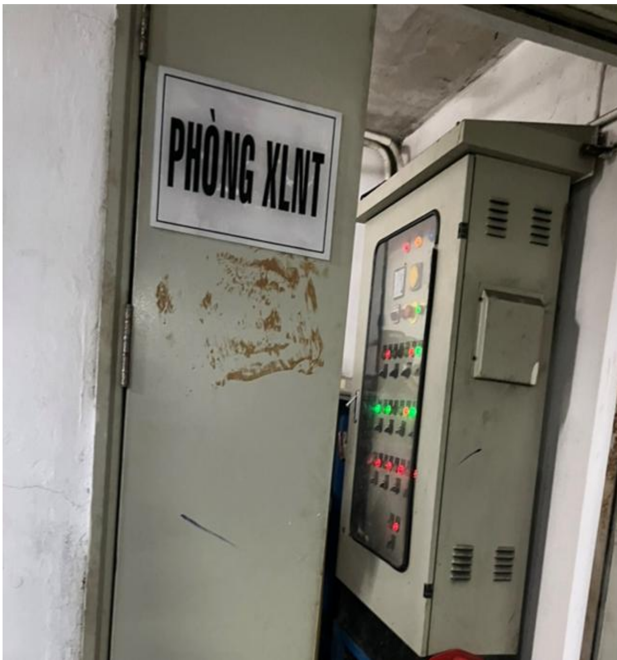
Hình 3. 6. Phòng xử lý nước thải của cơ sở đã xây dựng tại tầng hầm 1
