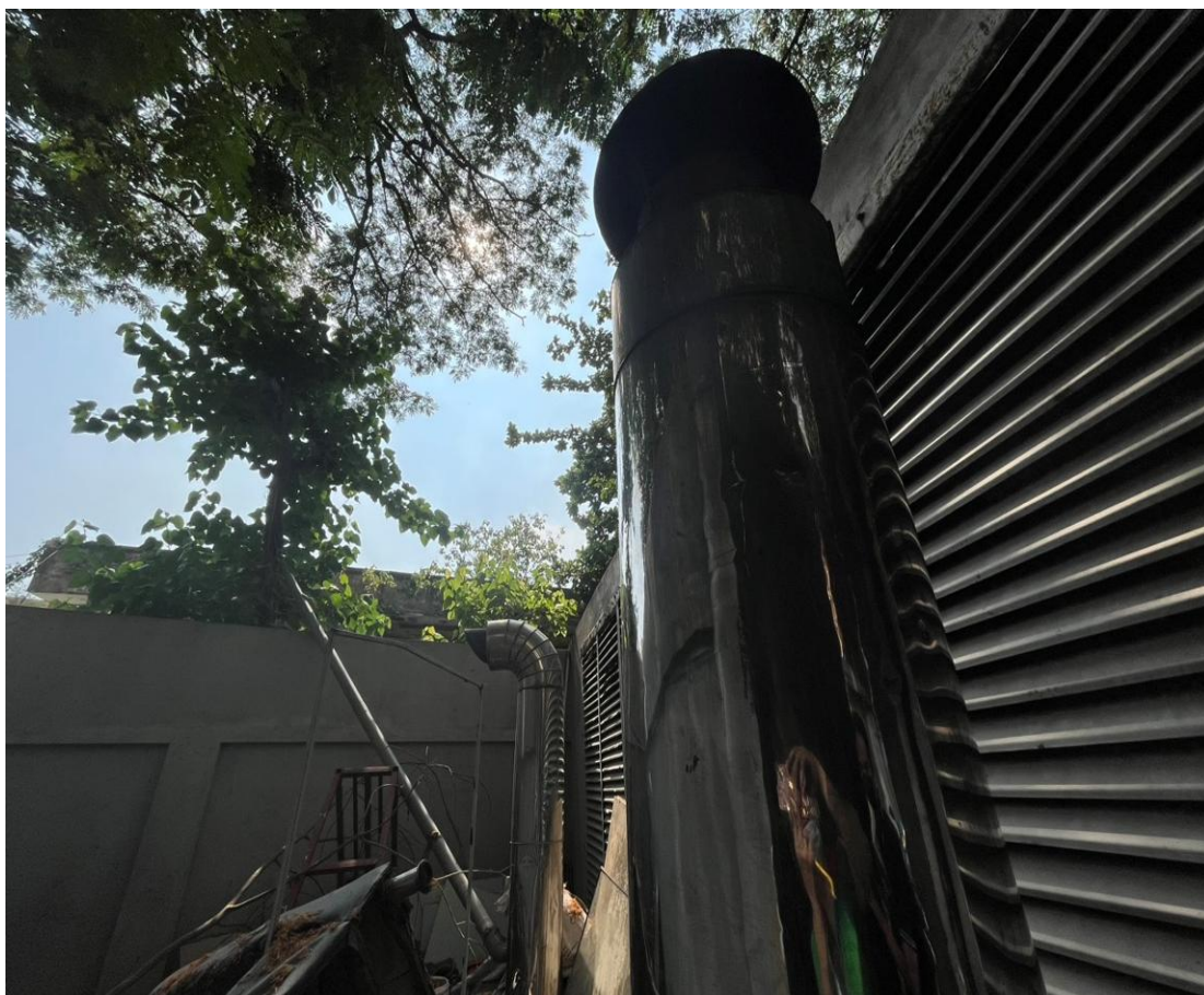
Hình 3. 8. ống khói của máy phát điện tại cơ sở
