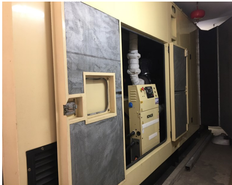
Hình 3. 11: Máy phát điện tại cơ sở.
