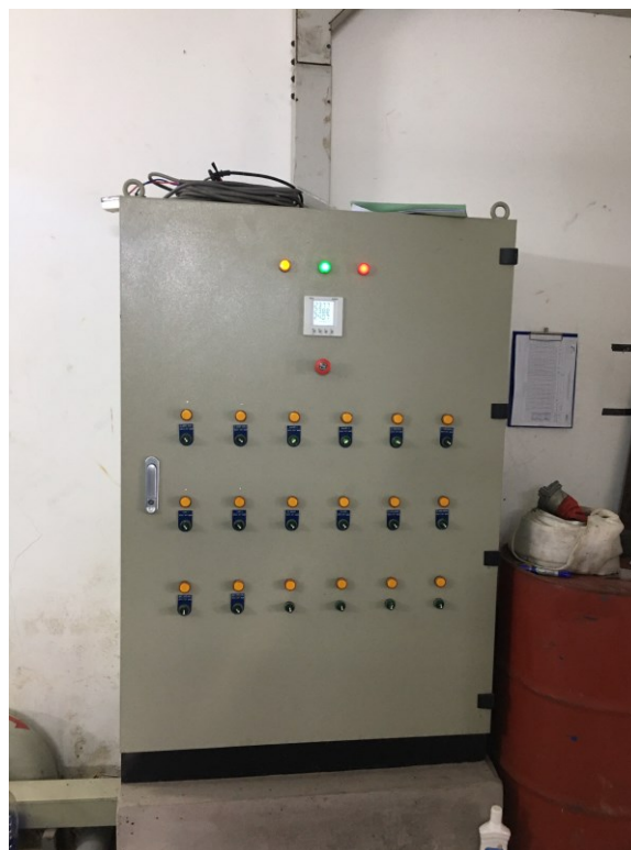
Hình ảnh Tủ điện
