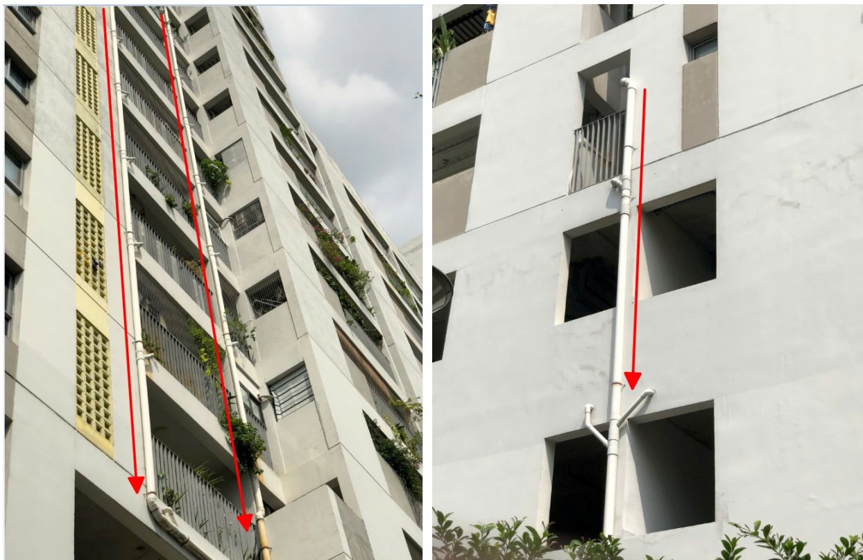
Hình 3. 2: Ống thu nước mưa khu lan can và nhà xe tầng 1 và 2
