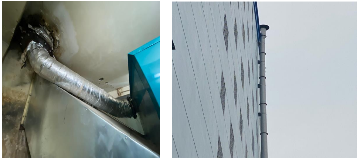
Hình 3.10. Ống khói máy phát điện
