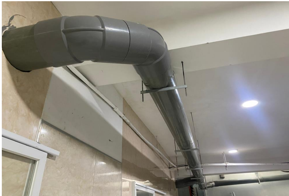
Hình 3.12. Ống thoát mùi tại hệ thống xử lý nước thải với công suất 100\text{m}^3/\text{ngày đêm}
