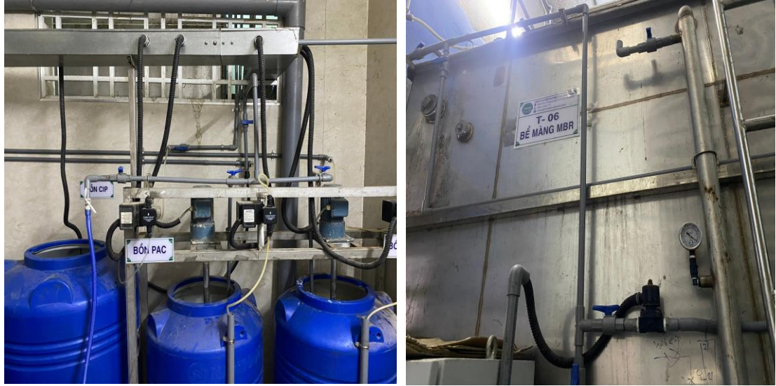
Hình 3.8. Hình ảnh về hệ thống xử lý nước thải tại cơ sở
