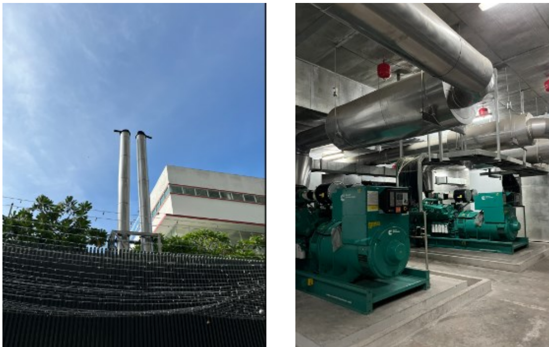
Hình 3.10. Máy phát điện và ống thoát khí máy phát điện
