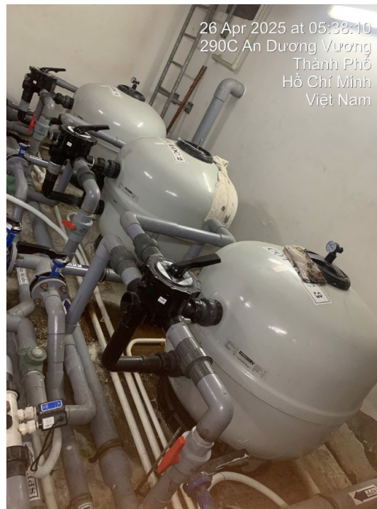
Hình 1. 4. Hệ thống lọc
