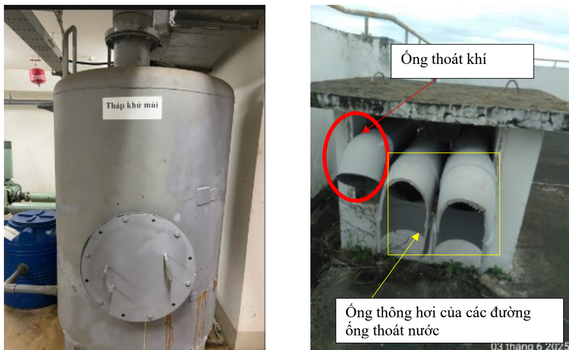
Hình 3. 9. Ống thoát khí từ hệ thống xử lý khí thải
