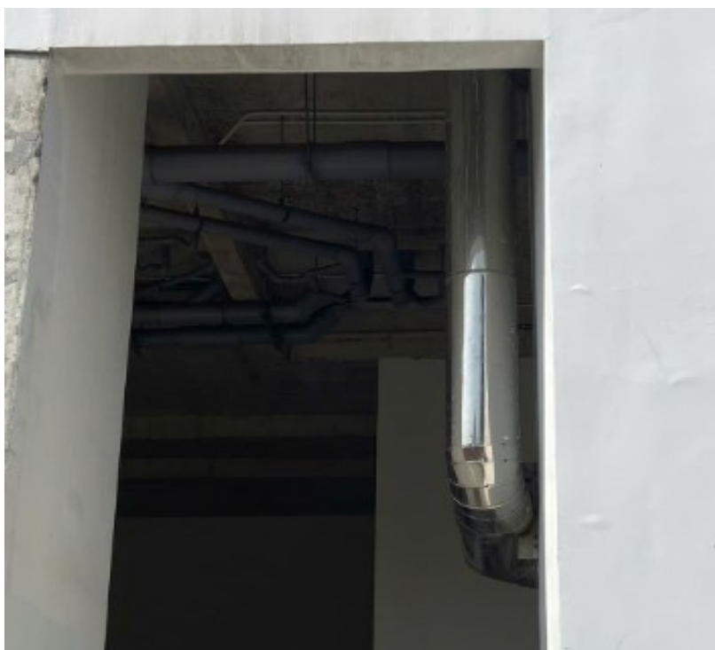
Hình 22. Hình ảnh ống thoát khí thải của khối nhà B
