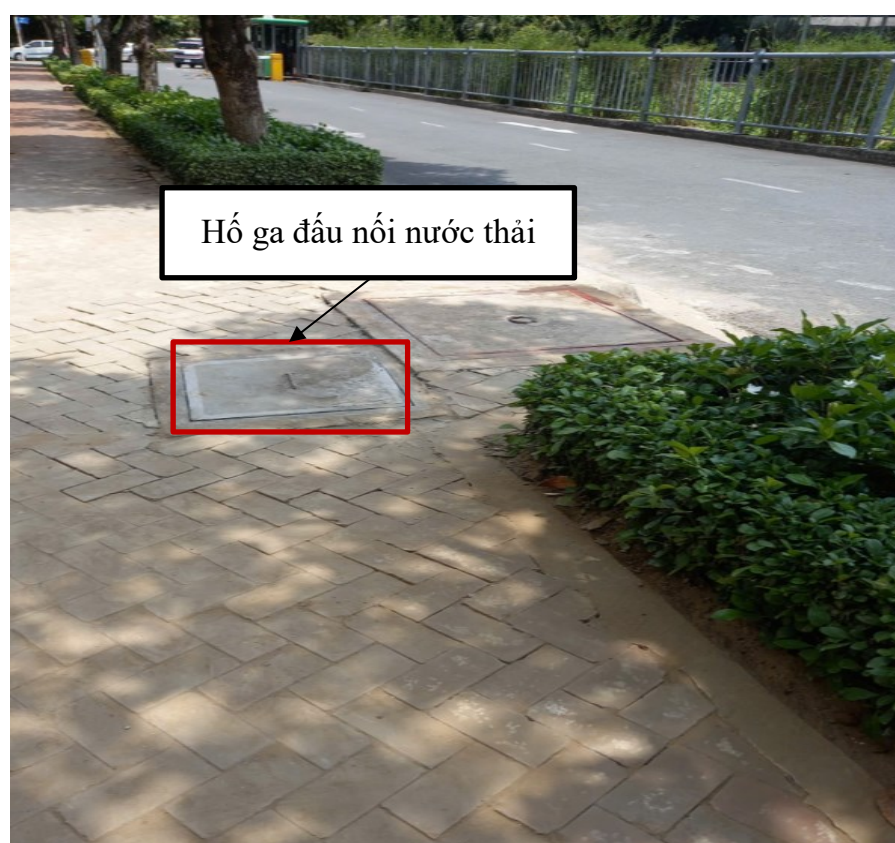
Hình 11. Hình ảnh hố ga đầu nối tại cơ sở
