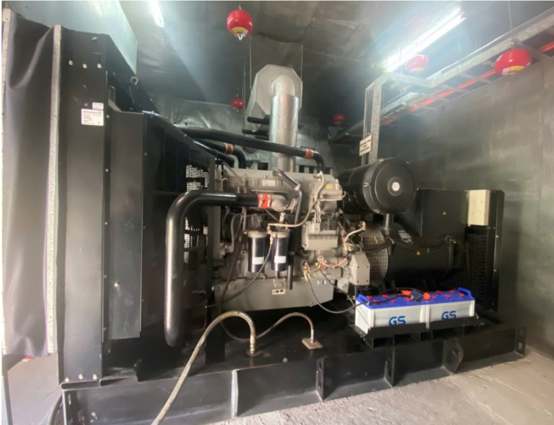
Hình 19. Hình ảnh máy phát điện của khối nhà A
