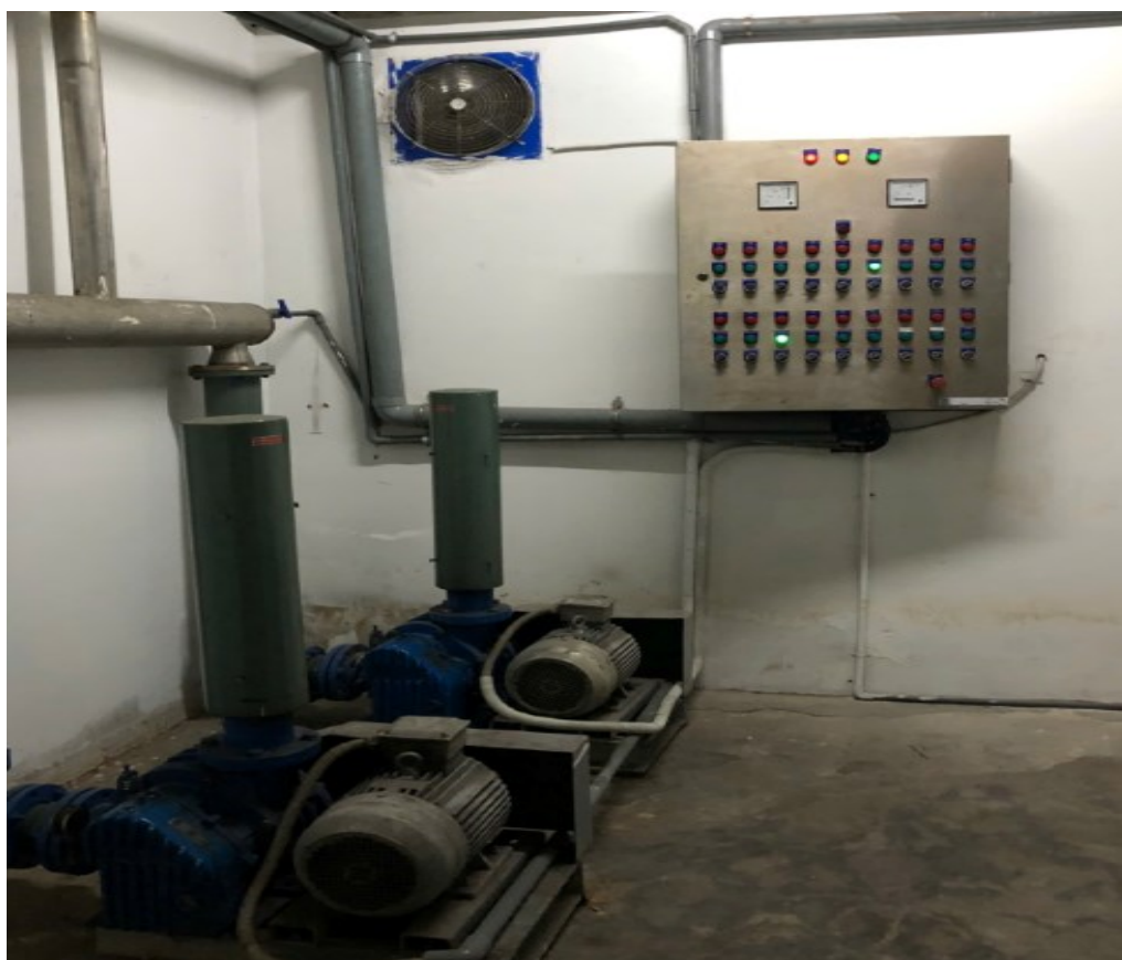
Hình 28. Máy móc thiết bị trong nhà điều hành được xây trong phòng kín
