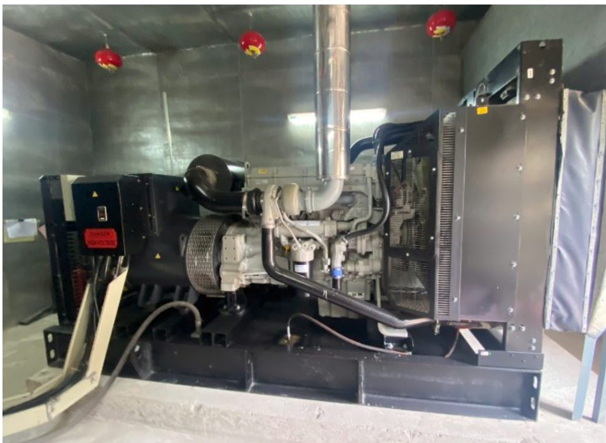
Hình 27. Hệ thống cách âm tiếng ồn từ phòng máy phát điện
