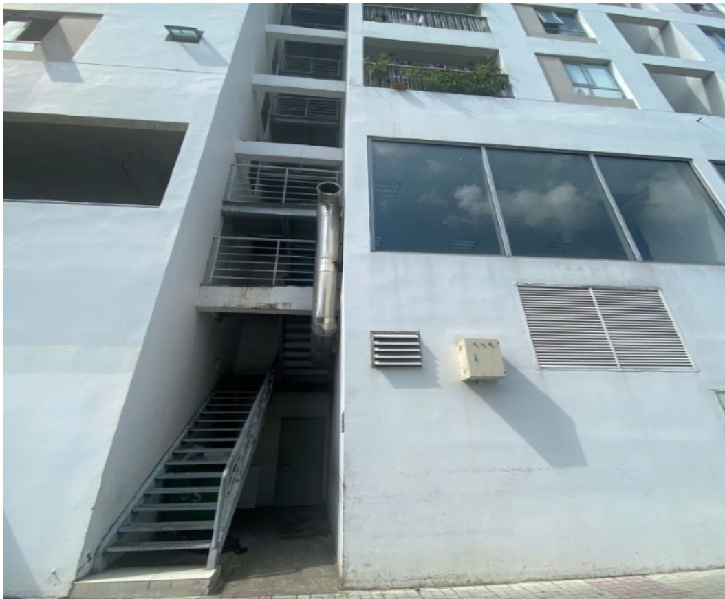
Hình 20. Hình ảnh ống thoát khí thải của khối nhà A
