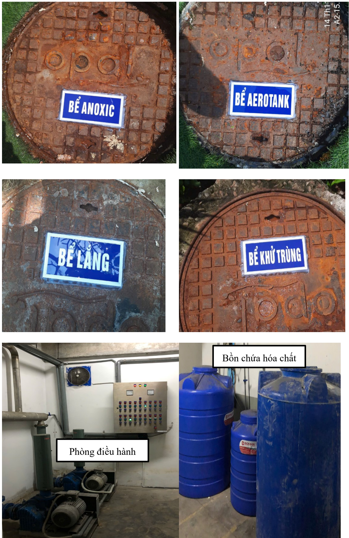
Hình 14. Hệ thống xử lý nước thải công suất 380 m 3 /ngày đêm
