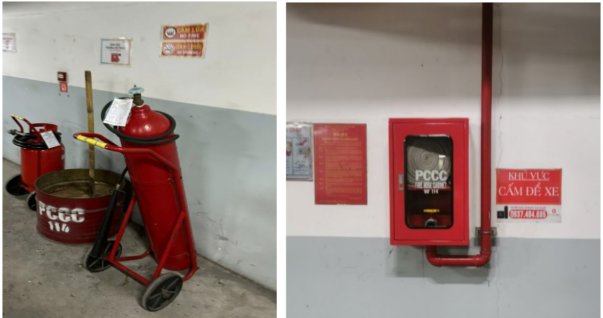
Hình 3.17: Hệ thống chữa cháy tại cơ sở
