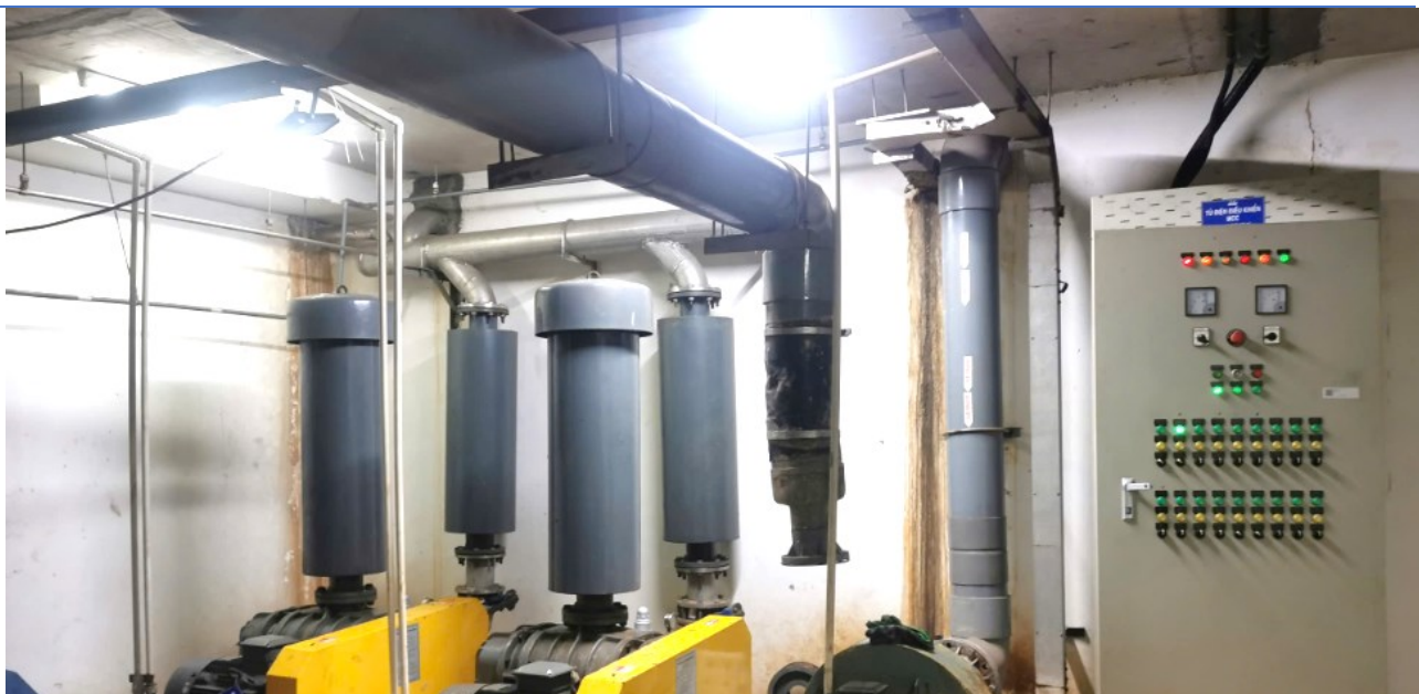
Hình 3.6: Phòng điều khiển hệ thống xử lý nước thải
