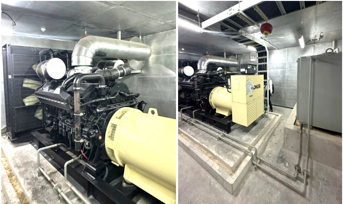
Hình 3.10: Máy phát điện dự phòng
