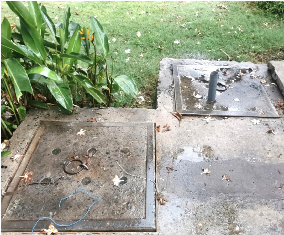
Hình 3.1: Các hố ga thoát nước mưa tại cơ sở
