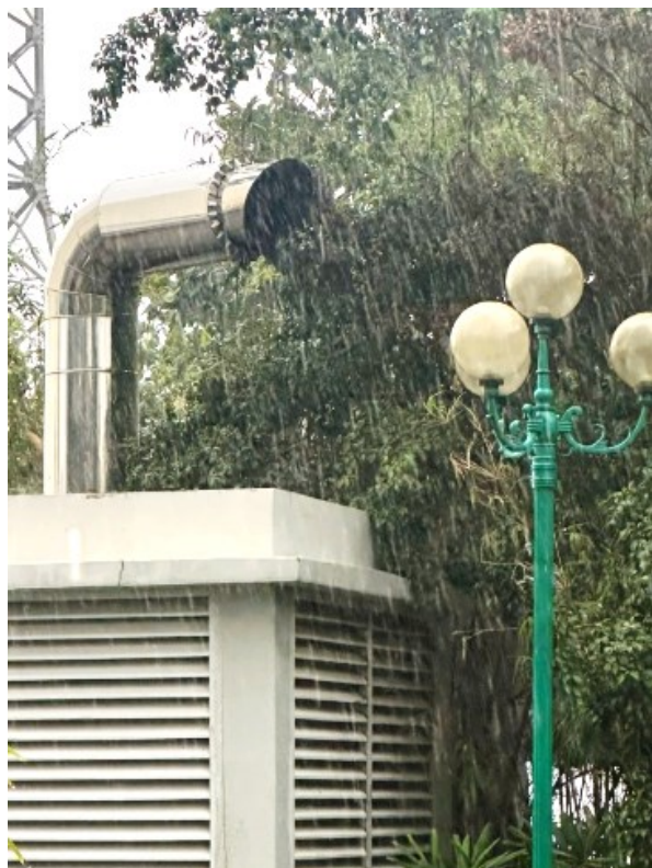
Hình 3.11: Ống khói máy phát điện dự phòng
