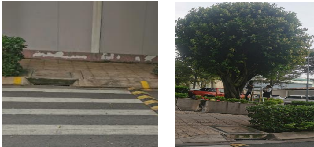
Hình 3.1: Các hố ga thoát nước mưa tại cơ sở
