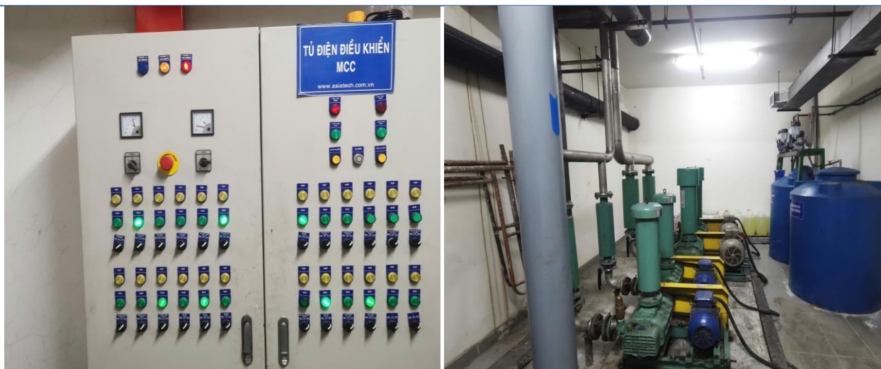
Hình 3.7: Phòng điều khiển hệ thống xử lý nước thải
