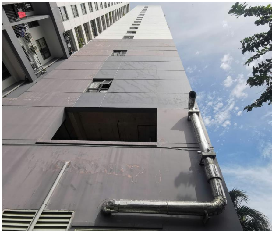
Hình 3.12: Ống khói máy phát điện dự phòng
