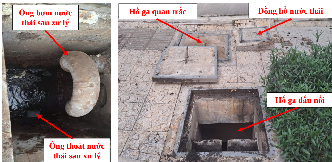
Hình 3.4: Hố ga quan trắc và hố ga đầu nối nước thải tại cơ sở
