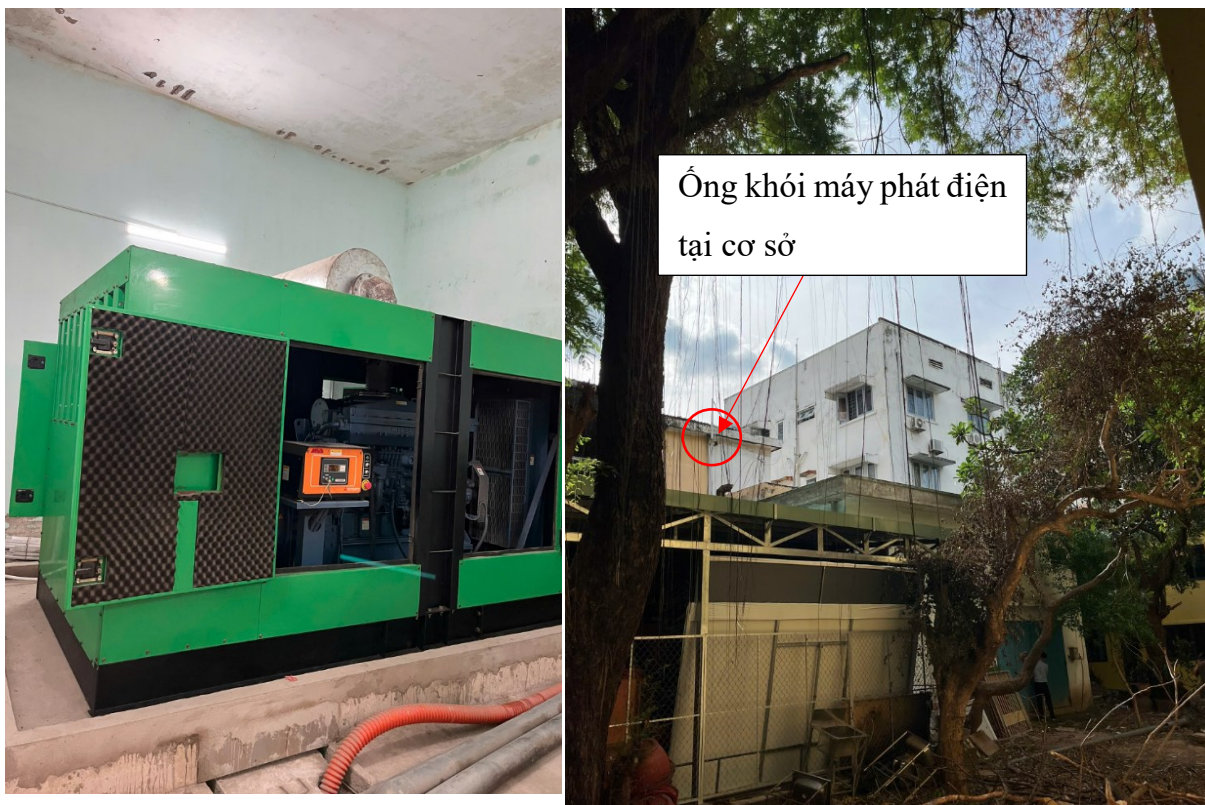
Hình 3. 8. Máy phát điện tại cơ sở
